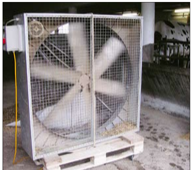
Mit mobilen Ventilatoren kann auch im Anbindestall ein genügender Luftaustausch erreicht werden
